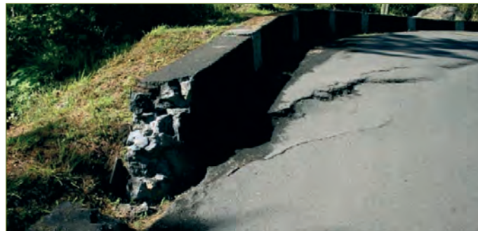
Déformation de la chaussée et de son parapet, révélant le glissement de Mare à Poule d'Eau. Photo R. Robert.
